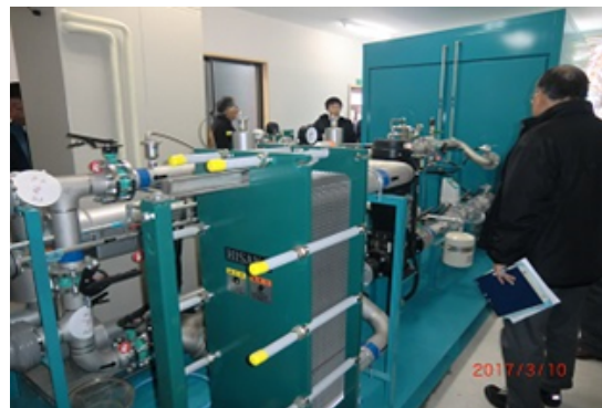
那須温泉バイナリー発電設備
